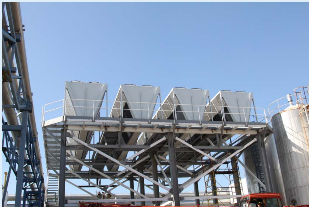
Четыре сухих охладителя GFD установлены на высоте 8 метров на стальной конструкции.
