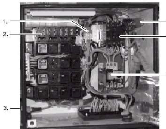
Рисунок 1-6. Электрический отсек - микропроцессорная система управления
