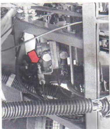
Branchement à la valve de prise d'air
